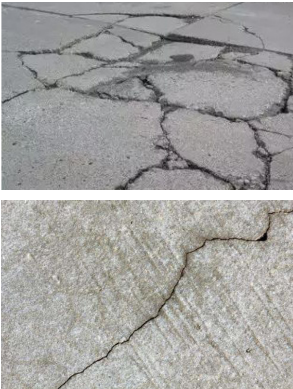
图1 混凝土道面板病害
